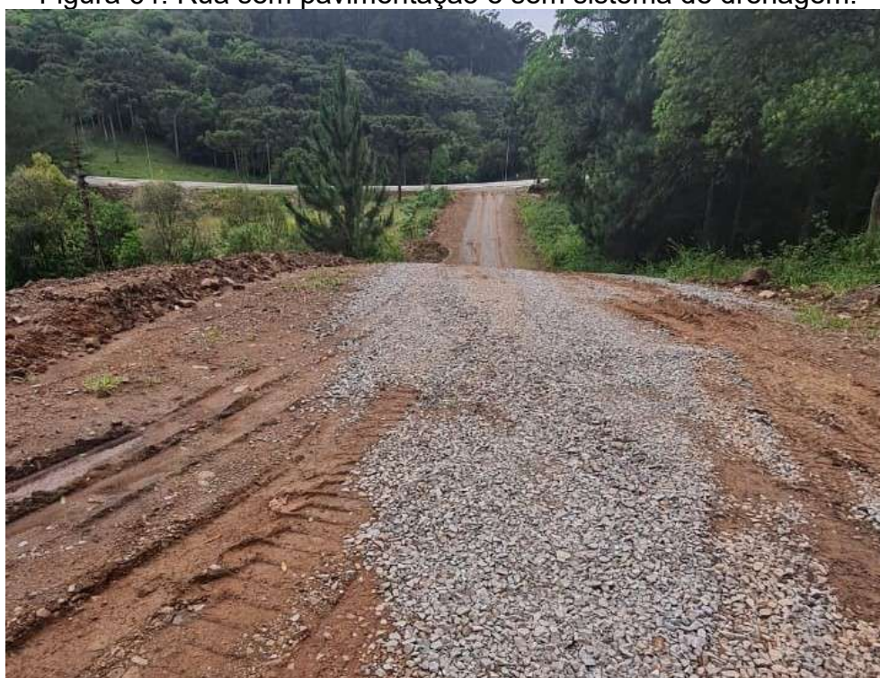
Figura 64: Rua sem pavimentação e sem sistema de drenagem.
