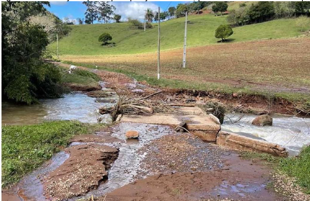
Figura 113: Situação após a precipitação histórica, ponte no interior do município.
