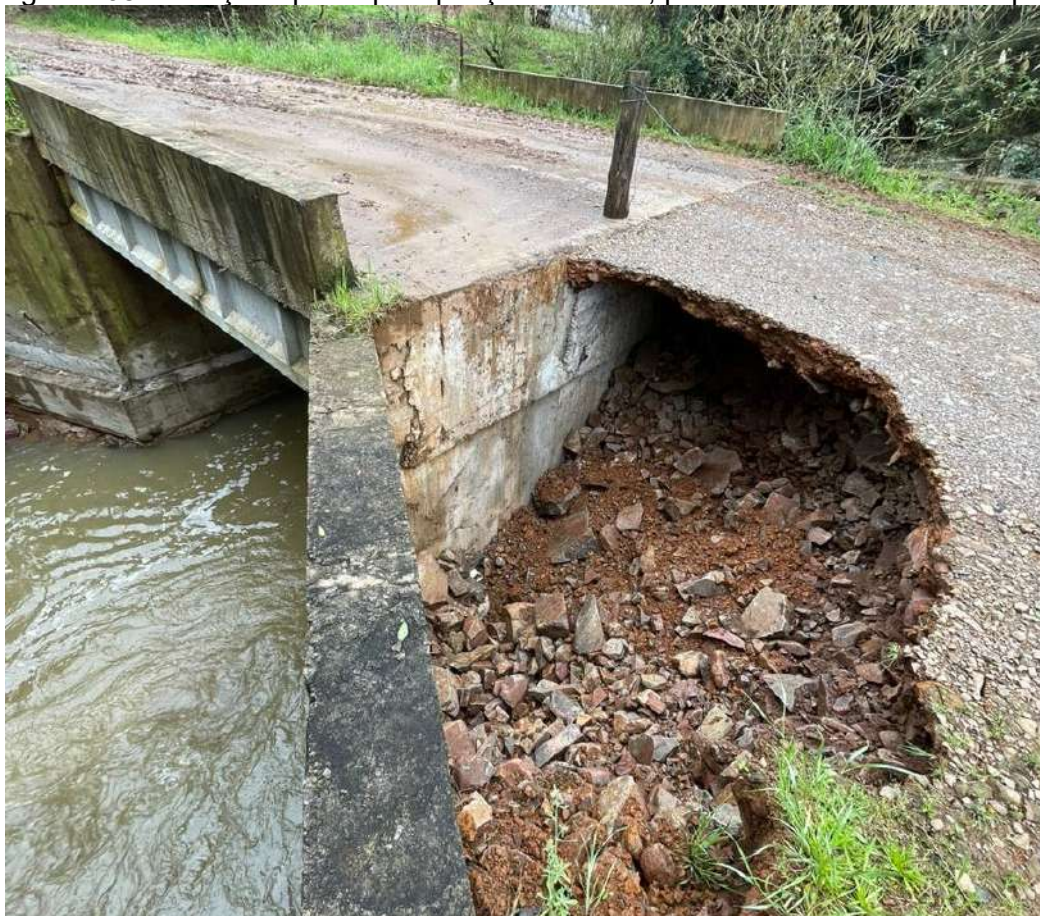
Figura 108: Situação após a precipitação histórica, ponte no interior do município.
