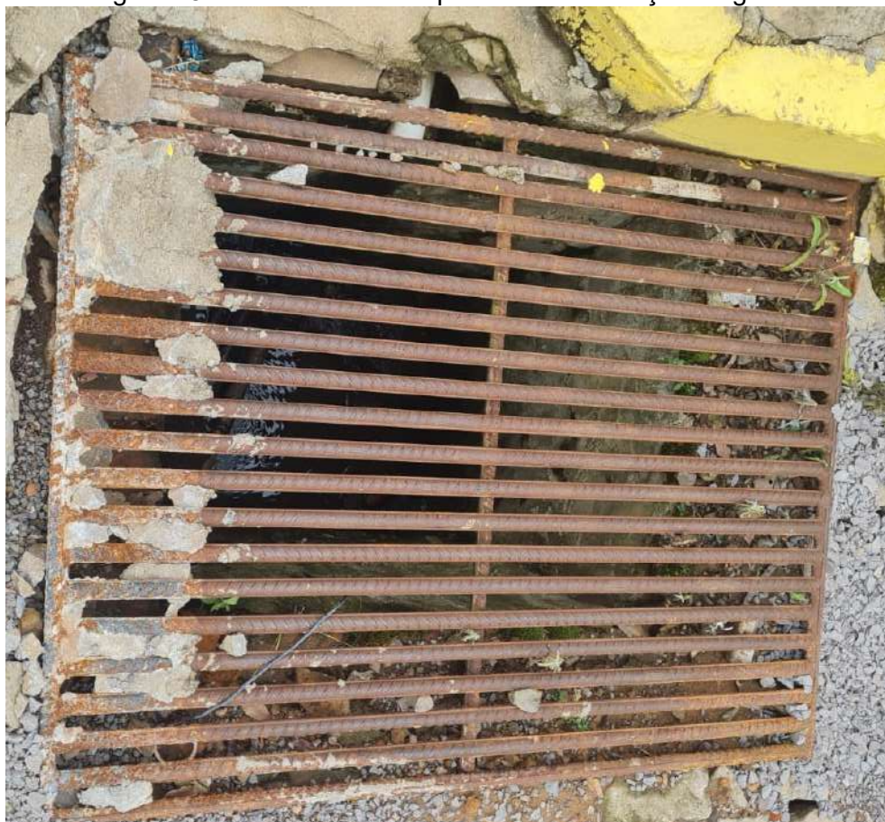
Figura 78: Boca de lobo com problemas de fixação na grade.
