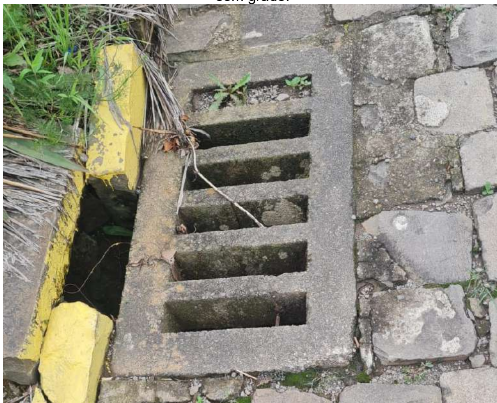
Figura 70: Boca de lobo pré-moldada de concreto com entrada horizontal e entrada lateral sem grade.
