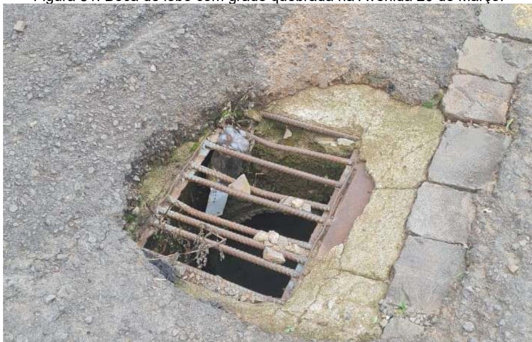
Figura 81: Boca de lobo com grade quebrada na Avenida 20 de Março.
