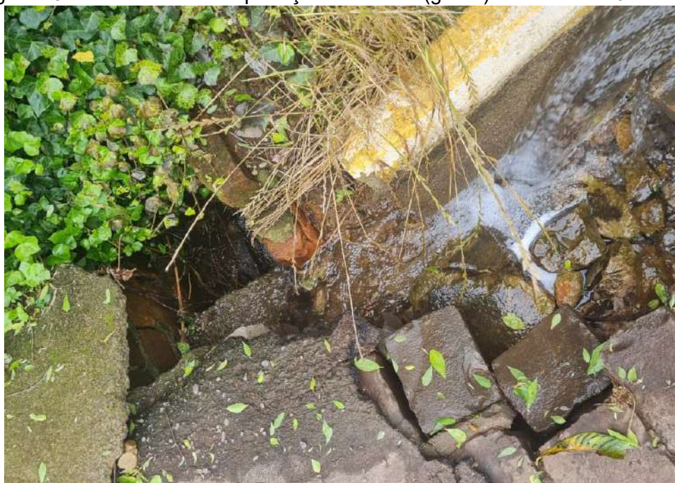
Figura 79: Boca de lobo sem proteção horizontal (grade) na Avenida 20 de Março.
