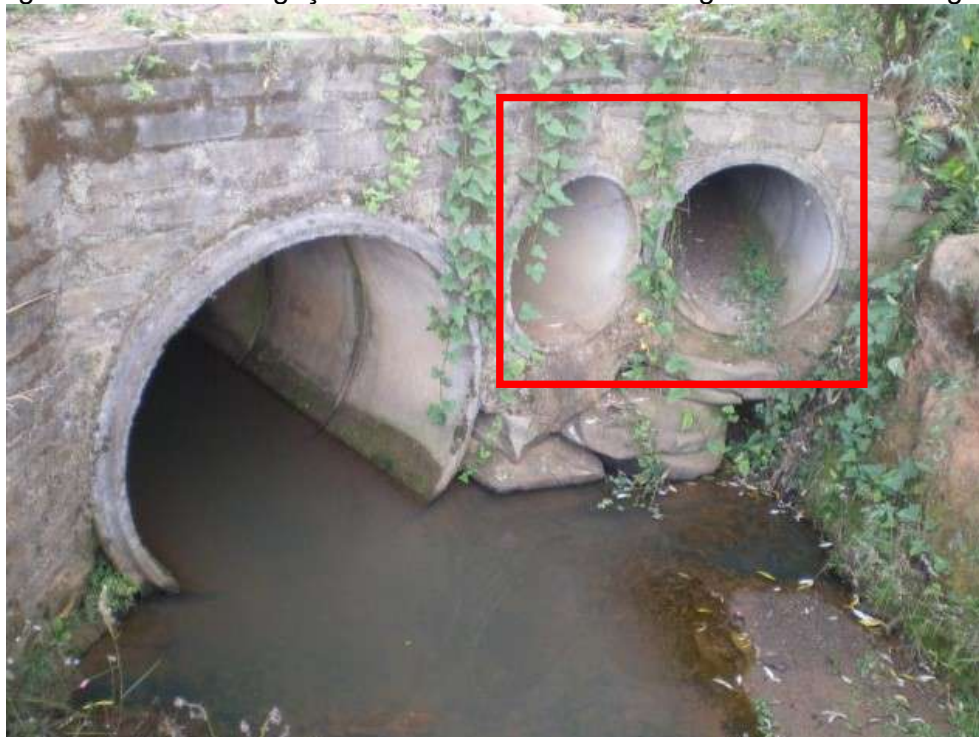
Figura 80: Dutos de ligação do sistema de microdrenagem com curso d'água.
