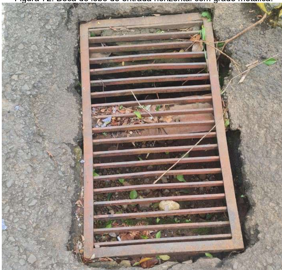
Figura 72: Boca de lobo de entrada horizontal com grade metálica.
