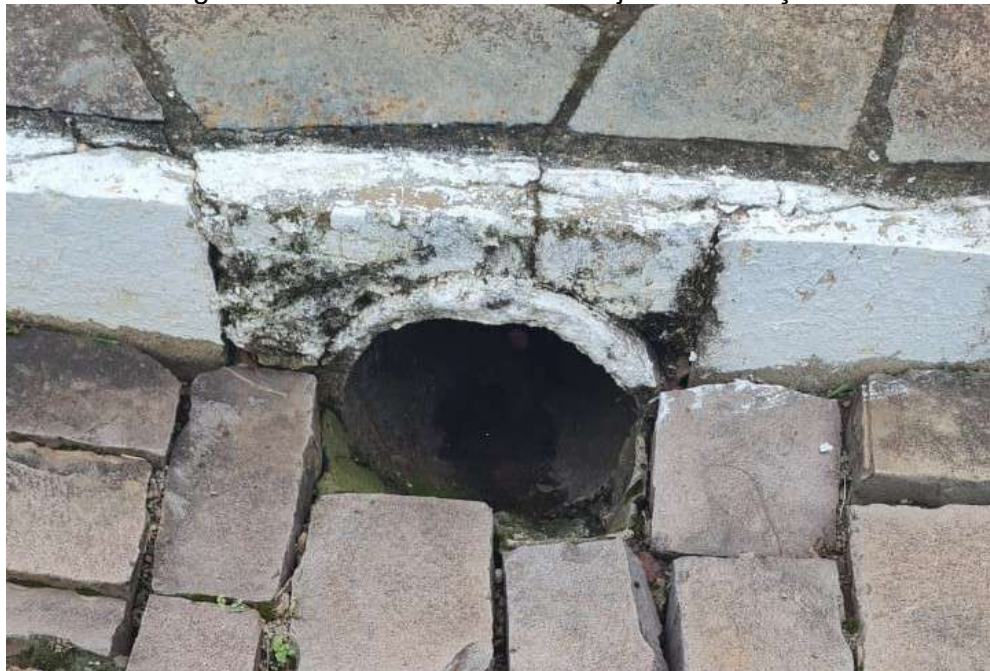
Figura 76: Entrada direta entre sarjeta e tubulação.
