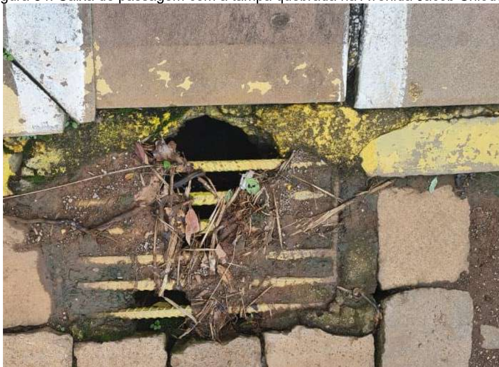
Figura 84: Caixa de passagem com a tampa quebrada na Avenida Jacob Chiodelli.
