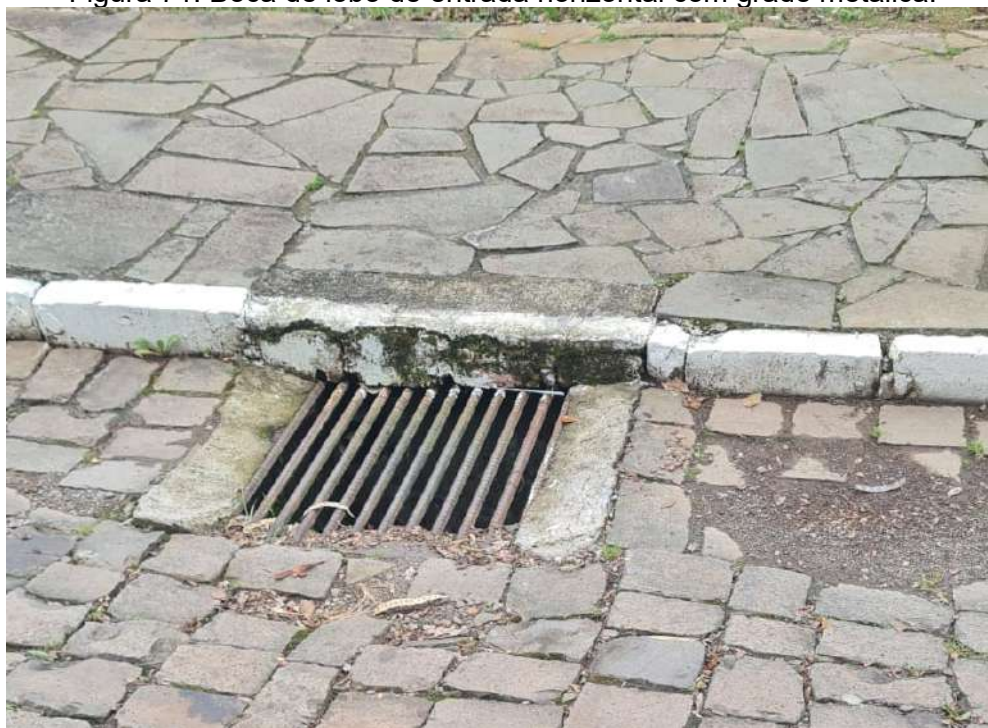
Figura 71: Boca de lobo de entrada horizontal com grade metálica.
