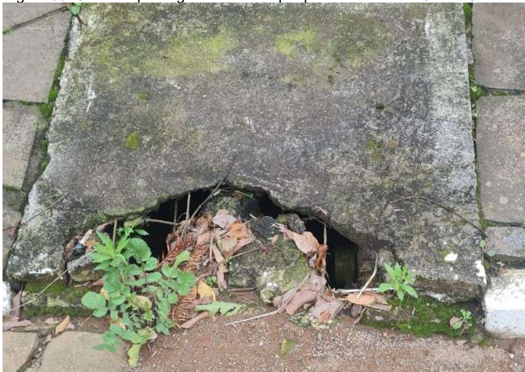
Figura 83: Caixa de passagem com a tampa quebrada Avenida Jacob Chiodelli.
