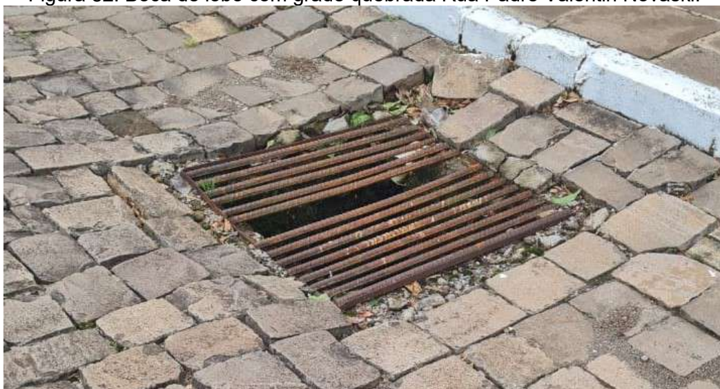
Figura 82: Boca de lobo com grade quebrada Rua Padre Valentin Novaski.
